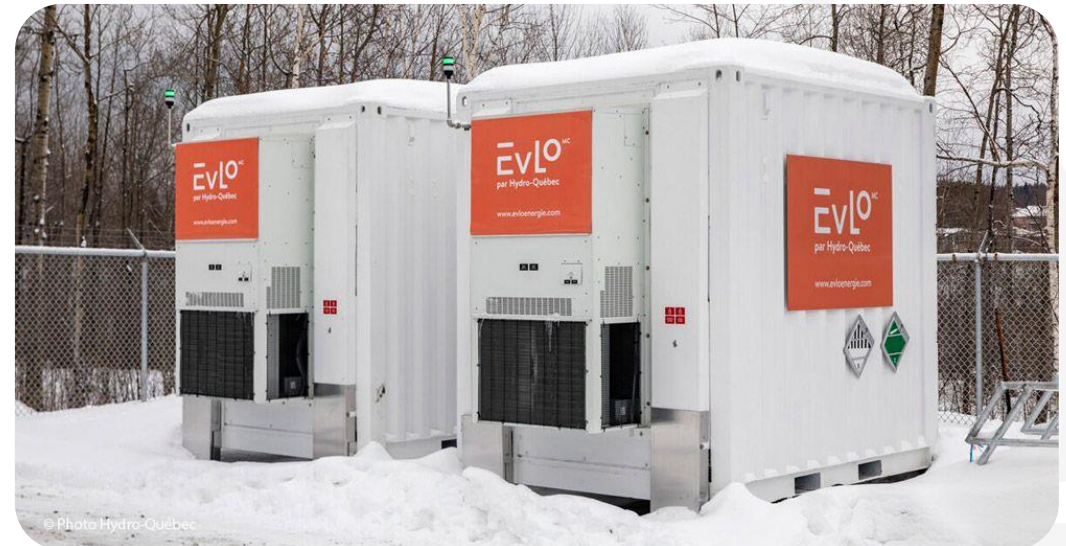
A solução de armazenamento de energia EVLO 500. (Crédito da imagem: EVLO)
